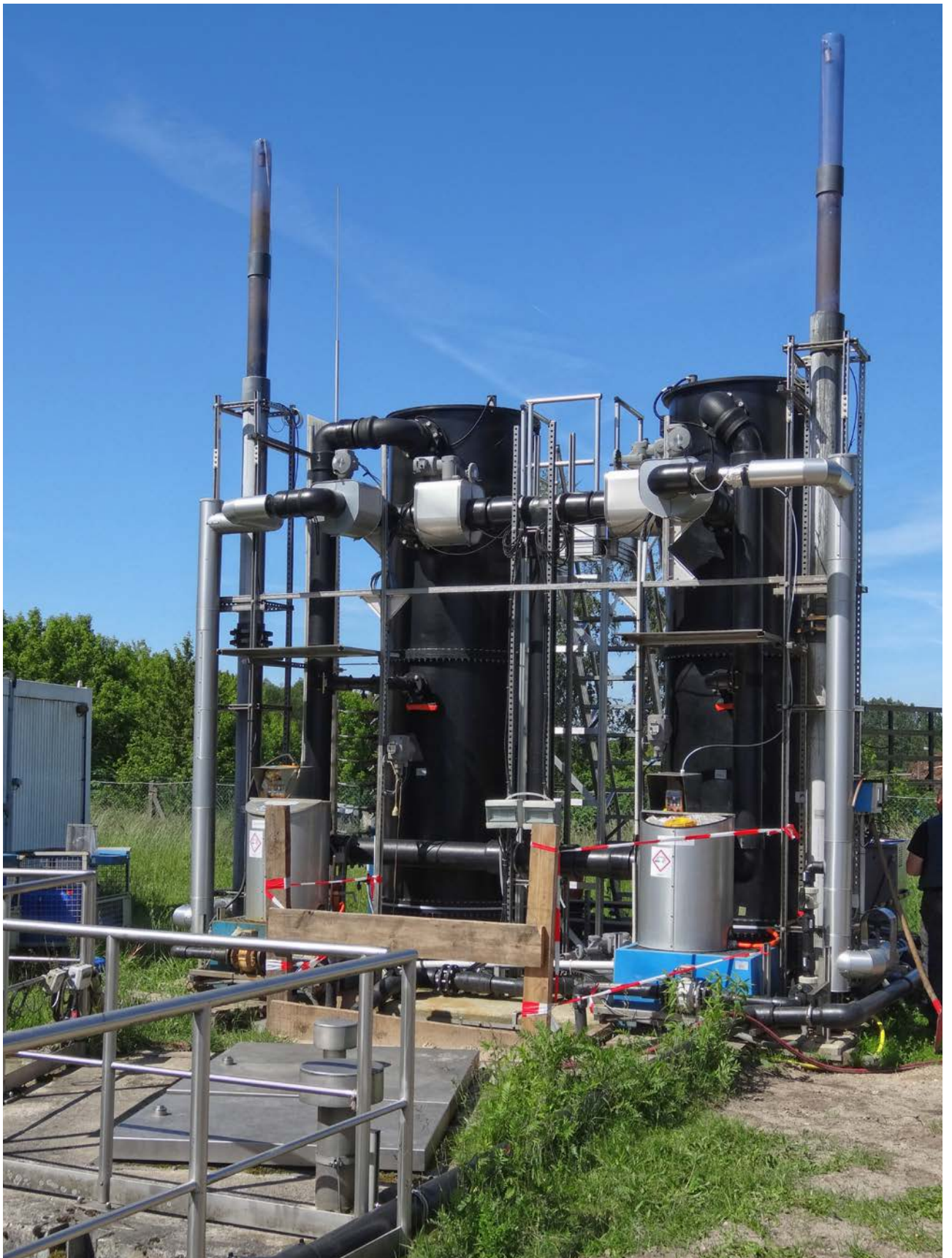
Bild 36: Ansicht der Flockungsfiltrationsanlage
