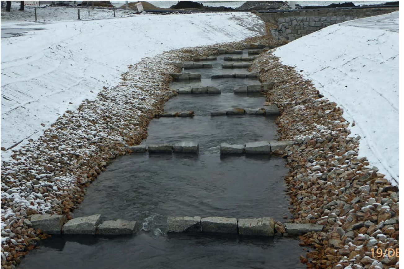
Bild 27: Ein Teil der Fischaufstiegsanlage im Detail
